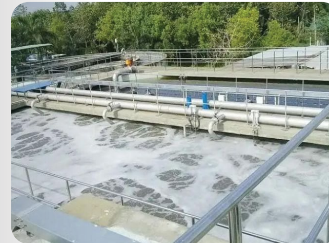
Hệ thống xử lý nước thải sản xuất bia rượu
