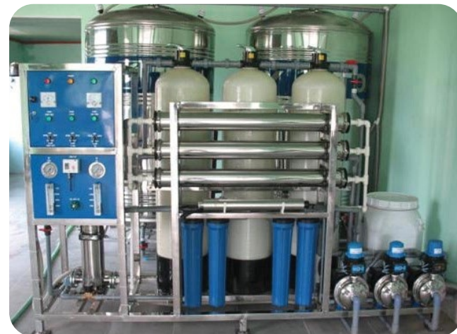
Hệ thống xử lý nước tinh khiết
