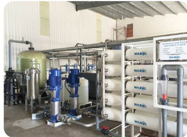
Hệ thống xử lý nước tinh khiết
