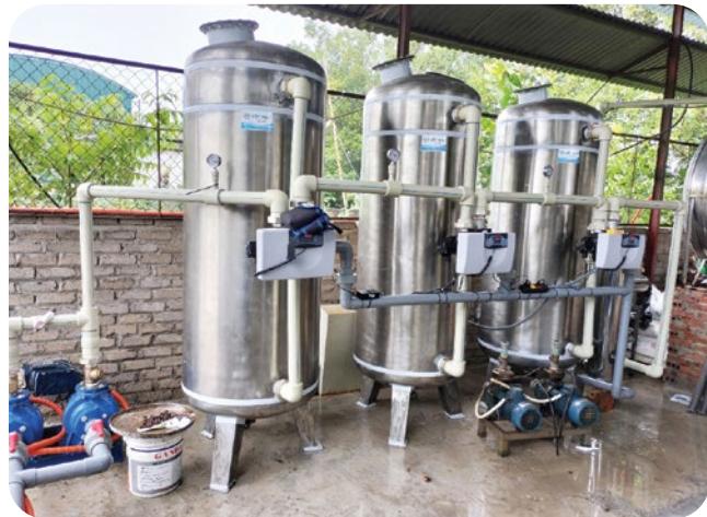
Hệ thống xử lý nước cấp sản xuất
