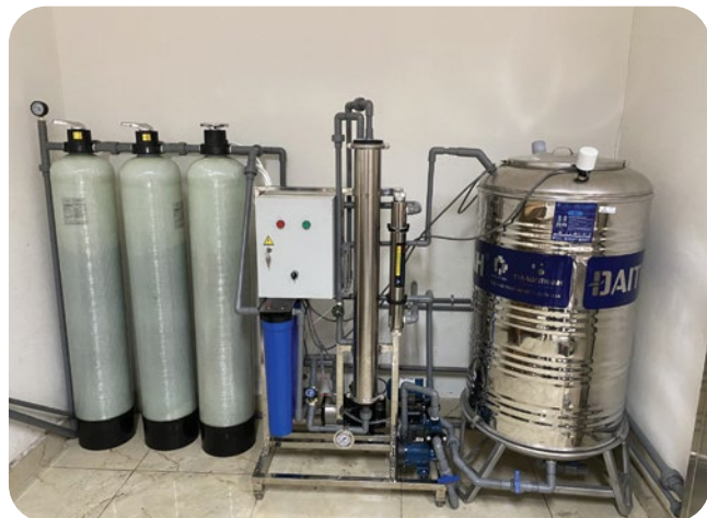
Hệ thống xử lý nước tinh khiết
