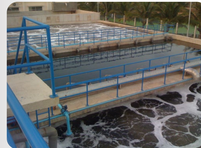
Hệ thống xử lý nước thải y tế
